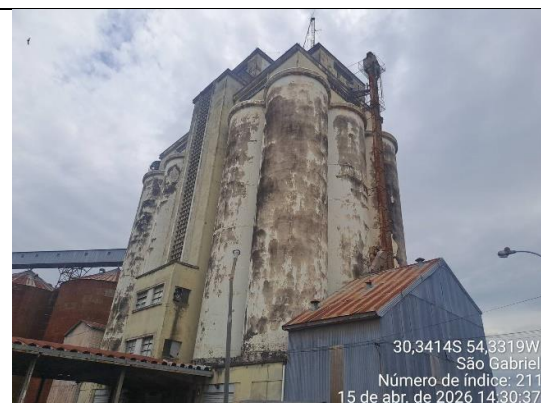
Foto 13 – Central de Beneficiamento e Silos de Concreto (10 unidades)
